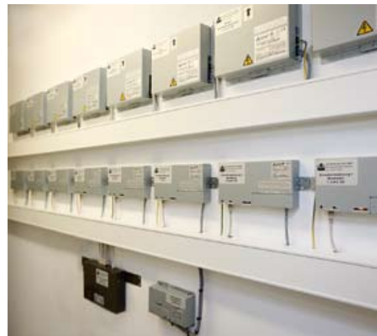
Die Zentralsteuerungen für die Klimatechnik im Teijin-Hochhaus
